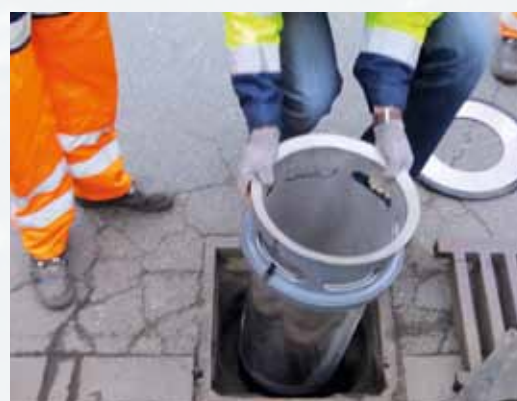
INNOLET® reinigt Niederschlagsabflüsse dezentral, noch bevor sie in den Regenwasserkanal bzw. in Oberflächengewässer gelangen.
